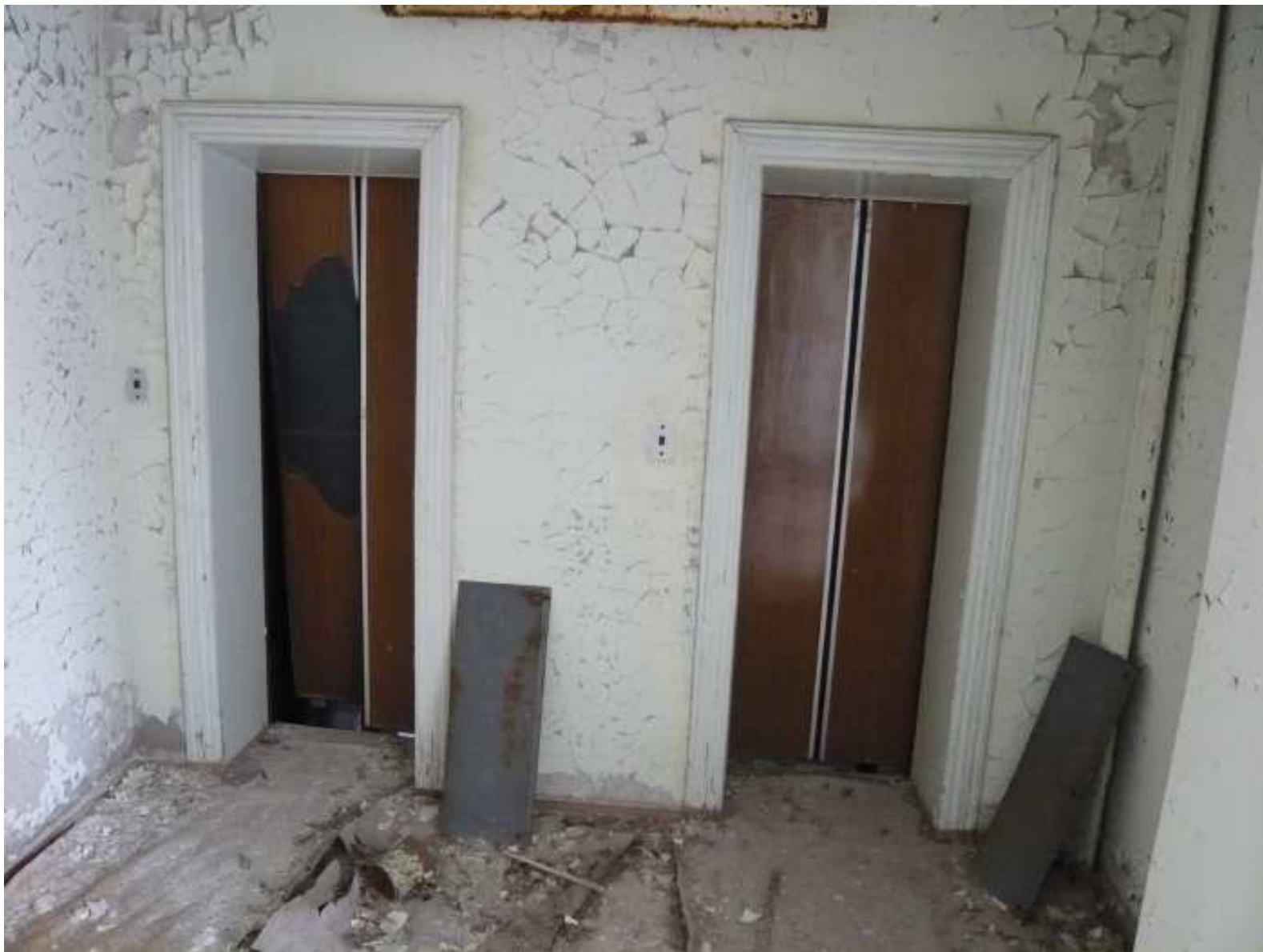
Portes de cages d'ascenseur
